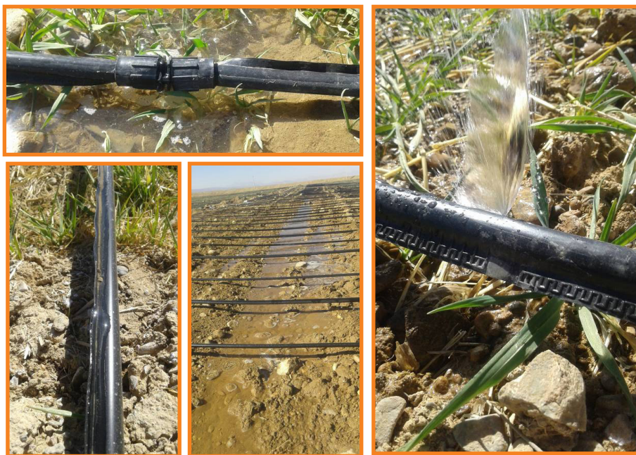
شکل ۹- ایجاد غیریکنواختی پخش آب در مزرعه بدلیل عدم رعایت مسایلی نظیر کیفیت لوله تیپ و اتصالات، تسطیح بستر و جهت قرارگیری قطره‌چکانهای تیپ بر روی خاک
